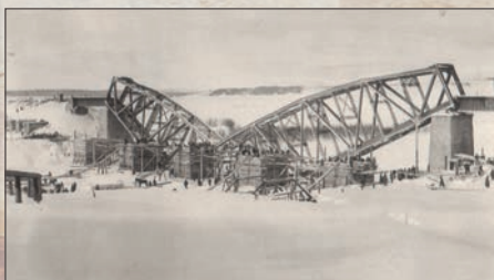
Oprava bolševiky strženého železničního mostu u Šumkova na kungurské frontě na Urale 20. prosince 1918 (zdroj VÚA–VHA)
